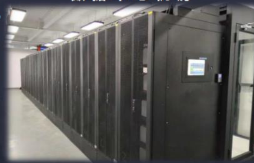
数据中心机房
